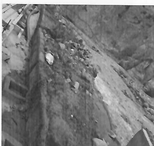
2.6 Tubería de evacuación de lavado de filtros: esta tubería es importante ya que evacua las aguas producto de lavado e filtro.
