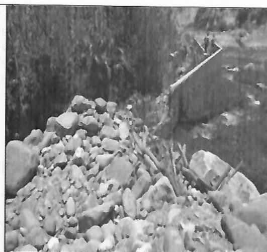
2.4 Canal de ingreso de agua cruda: se requiere realizar mejoras para evitar su colmatación y evitar el flujo de agua.
